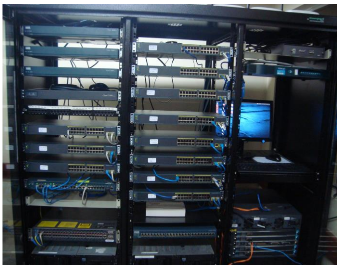
Figura 1: Rack com os equipamentos de redes
